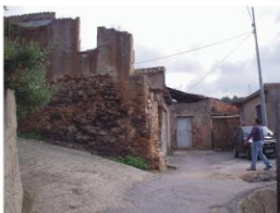
Come si presentano le case - I muri sono privi di intonaco, una volta presente, i piani superiori sono quasi totalmente distrutti.
